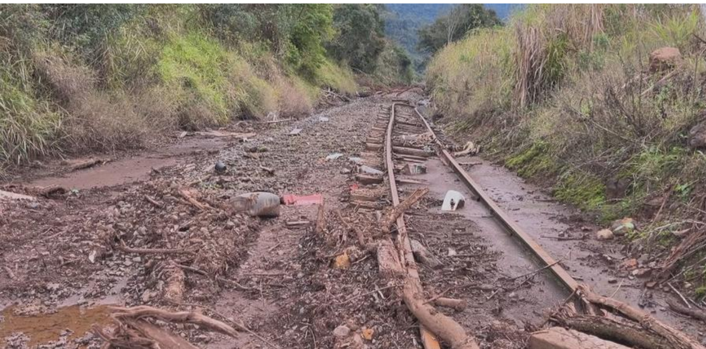
Ferrovia danificada após enchente no RS — Foto: Reprodução/RBS TV. Fonte: https://g1.globo.com/rs/rio-grande-do-sul/noticia/2024/07/23/ferrovias-do-rs-estao-isoladas-do-restante-do-pais-desde-as-enchentes.ghml
